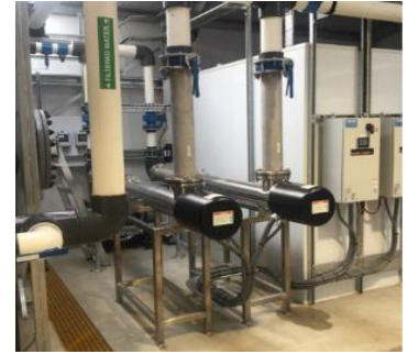
Raetihi WTP UV units
